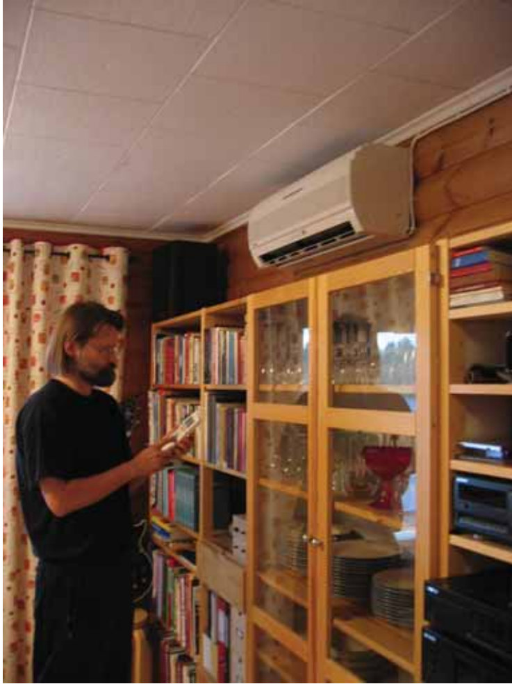
Sisäyksikkö. Omistaja tutkii hämmentyneenä laitteen monipuolisia säätö- ja ajastusmahdollisuuksia.
