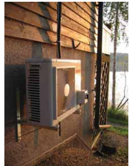
Ulkoyksikkö tukevasti kivijalassa, takana näkyv sisäyksikön kondenssivesiputki
