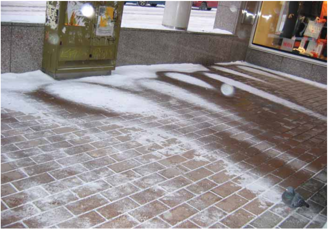
Sulatusputkien epäonnistunut asennus: liukastumisvaara todennäköinen.
